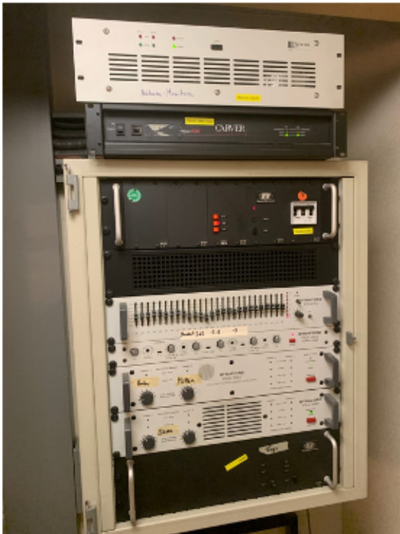
Verstärker Anlage Regieraum
